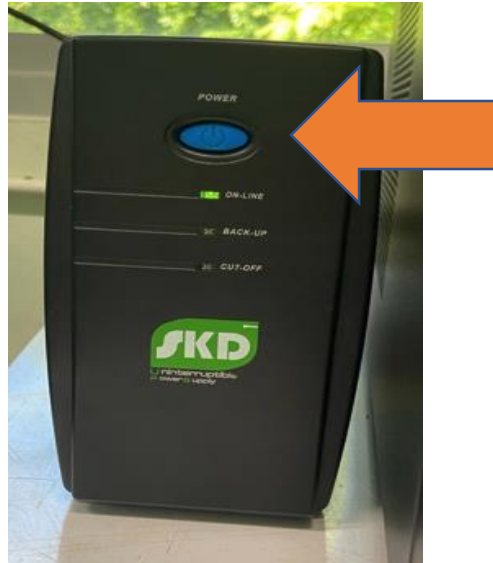
รูปที่ 15 เครื่องสำรองไฟ
