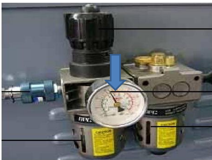
รูปที่ 37 วาล์วควบคุมแรงดัน
