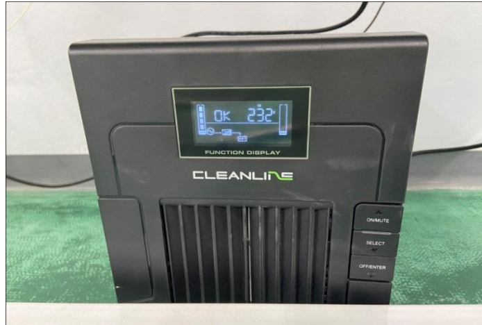
รูปที่ 9 เครื่องสำรองไฟ
